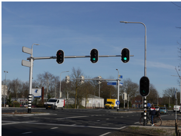
Zweepmast gecombineerd met NBD + OV
