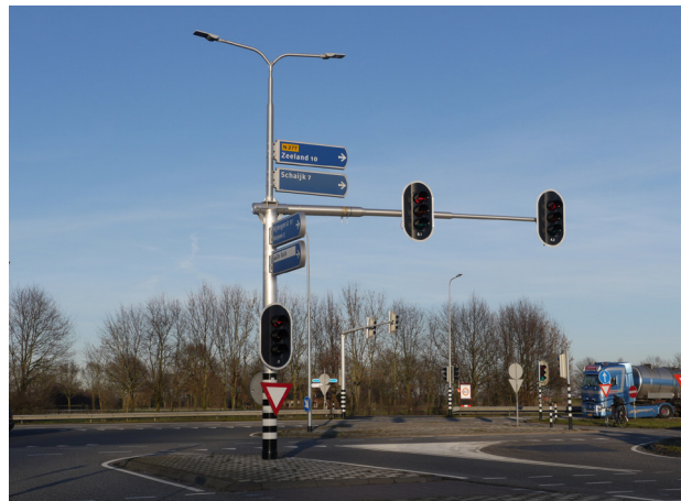
Zweepmast gecombineerd met NBD + OV
